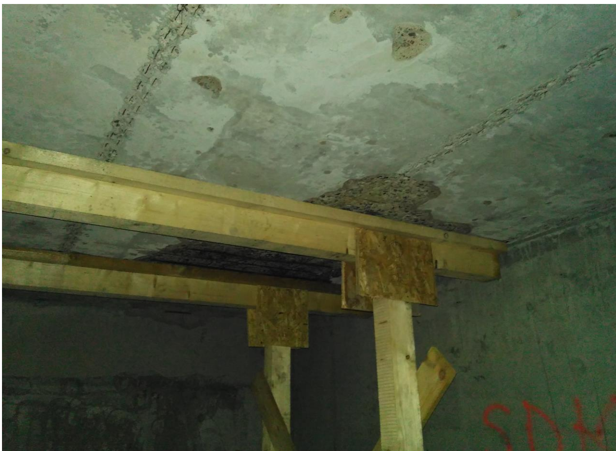
Obr. 4: Pohled na porušenou krycí vrstvu železobetonu a podepření stropní desky
