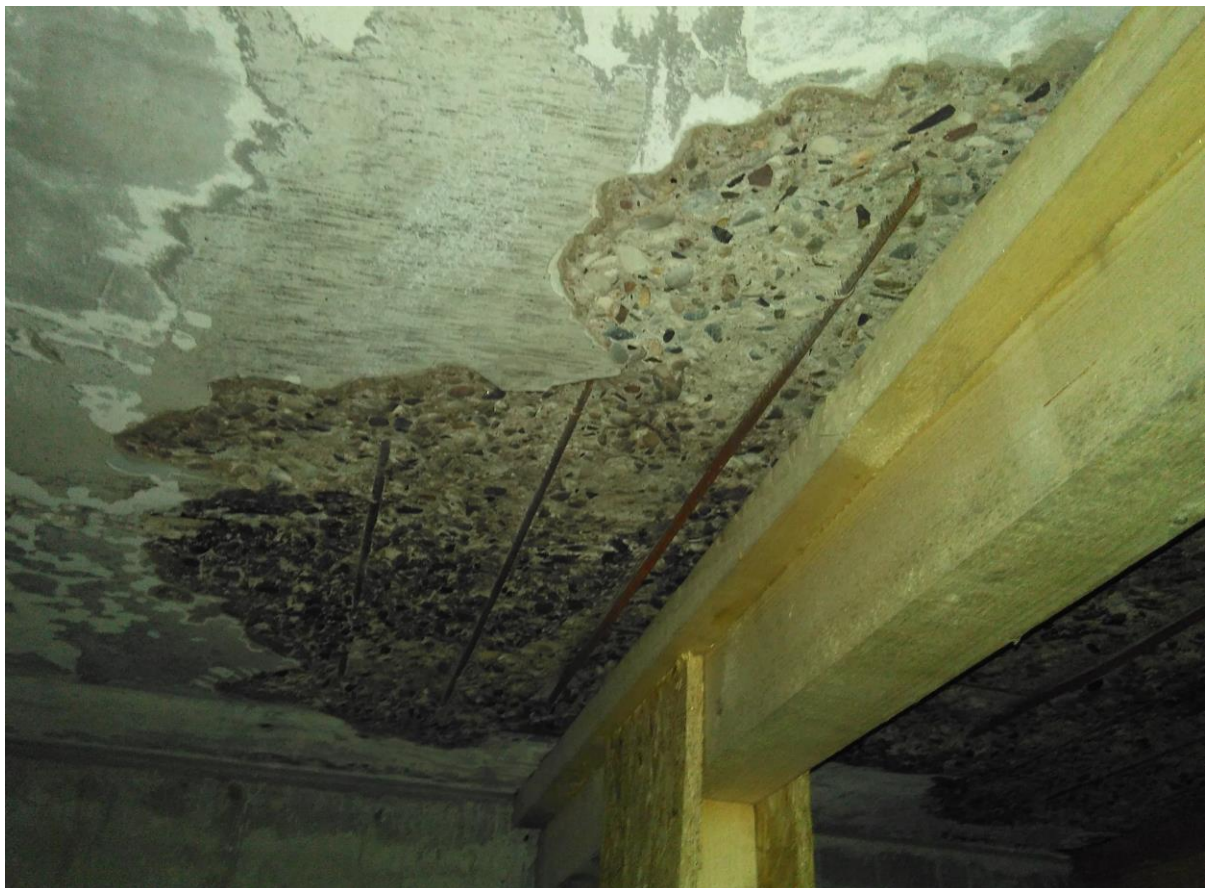
Obr.3: Pohled na porušenou krycí vrstvu železobetonu a podepření stropní desky
