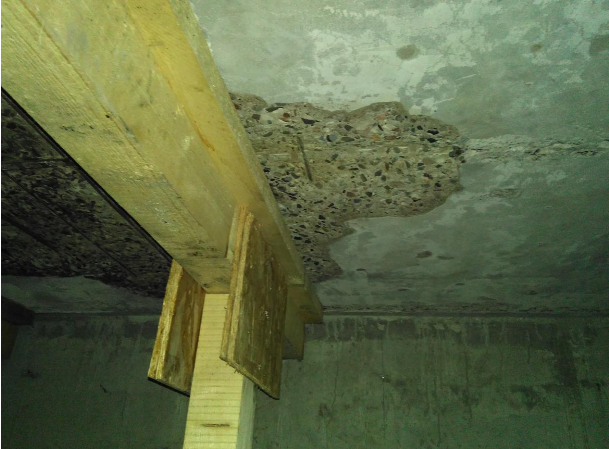
Obr.2: Pohled na porušenou krycí vrstvu železobetonu a podepření stropní desky
