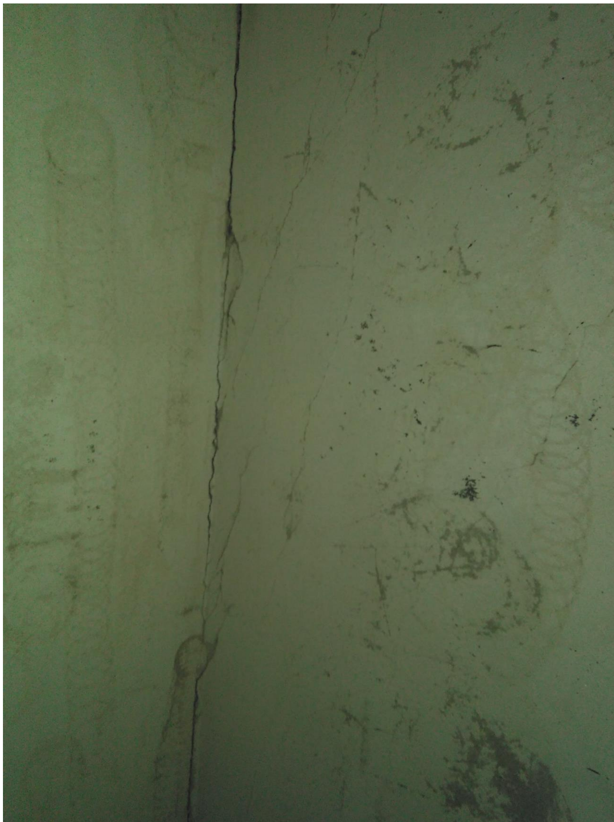
Obr.5: Pohled na prasklinu v místě napojení příček
