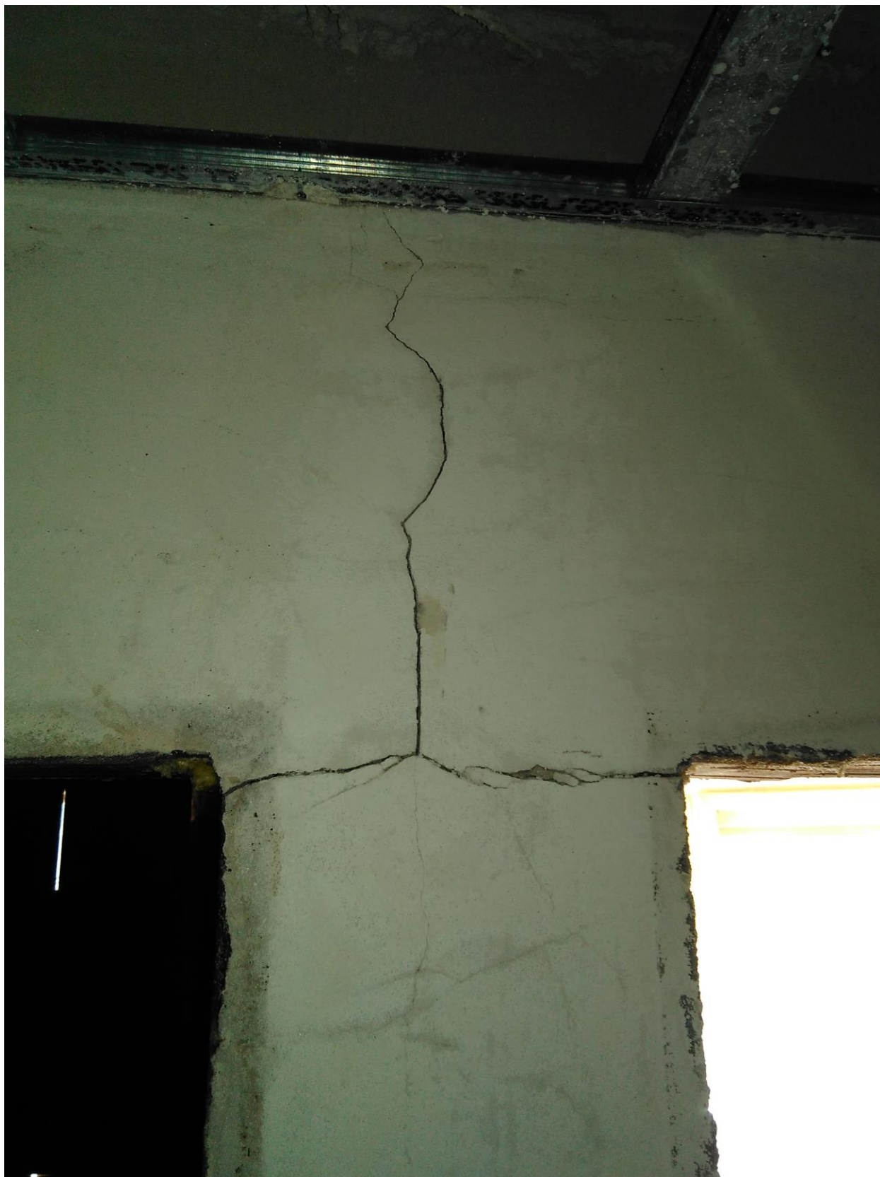
Obr.6: Pohled na prasklinu v dělicí přičce mezi obývacím pokojem a pokojem
