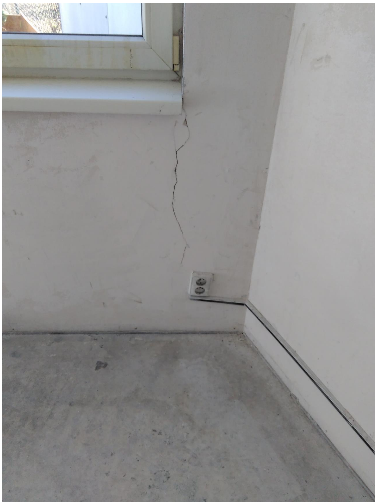
Obr. 7: Pohled na prasklinu v parapetu okenního otvoru
